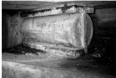
Rollenlager einer Brücke mit beginnender Korrosion
